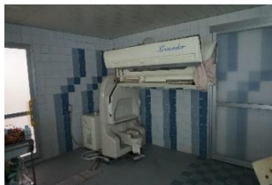
特殊浴槽（介助浴）の様子
